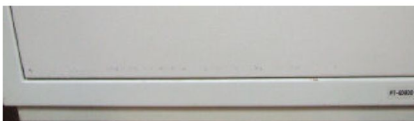
傷：扉正面下部
